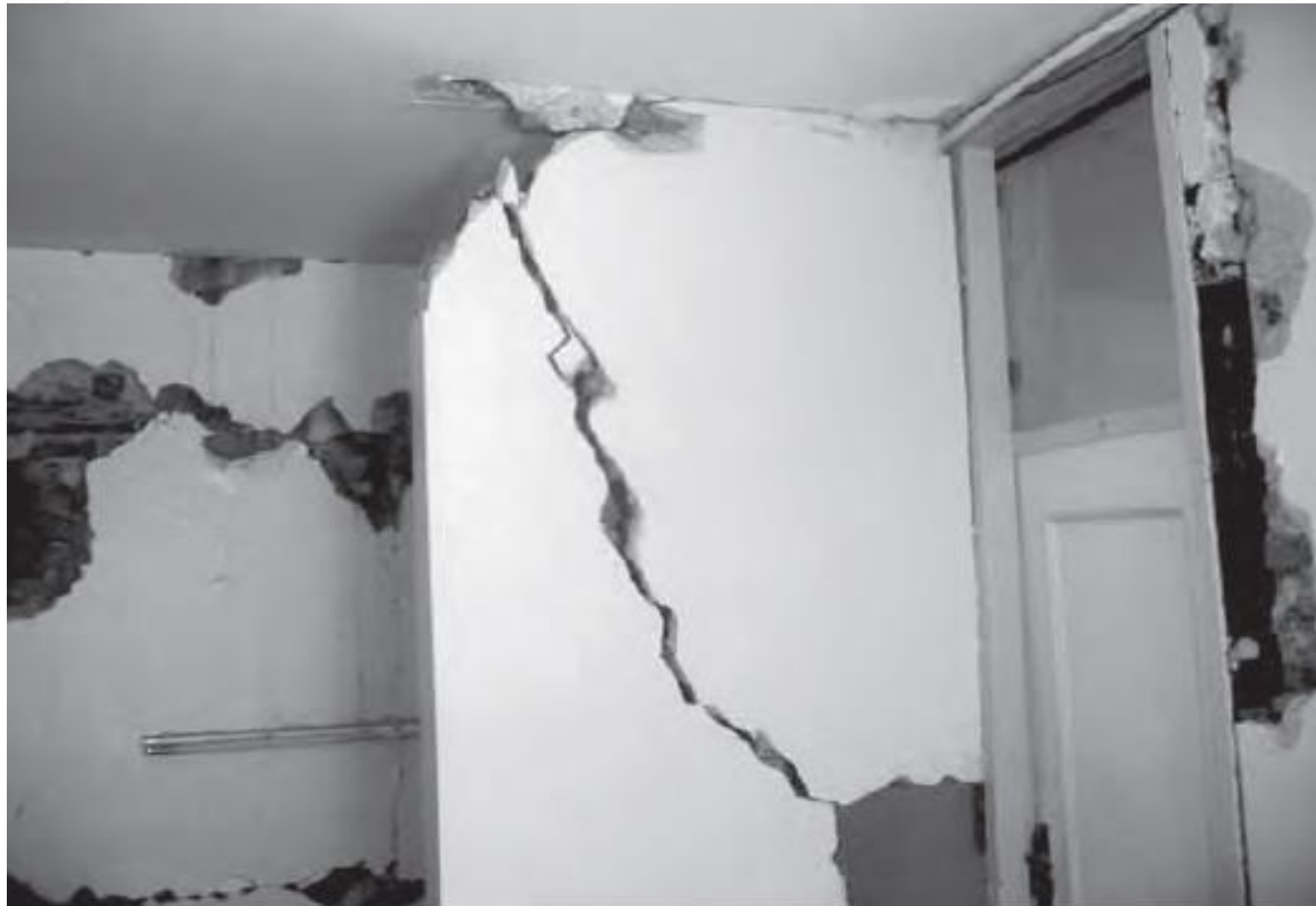
خسارات وارد شده به تیغه‌های بنایی در زلزله ۱۳۸۵ لرستان حفاظت شخصی و گروهی در شرایط جنگ - حامد حقانی
