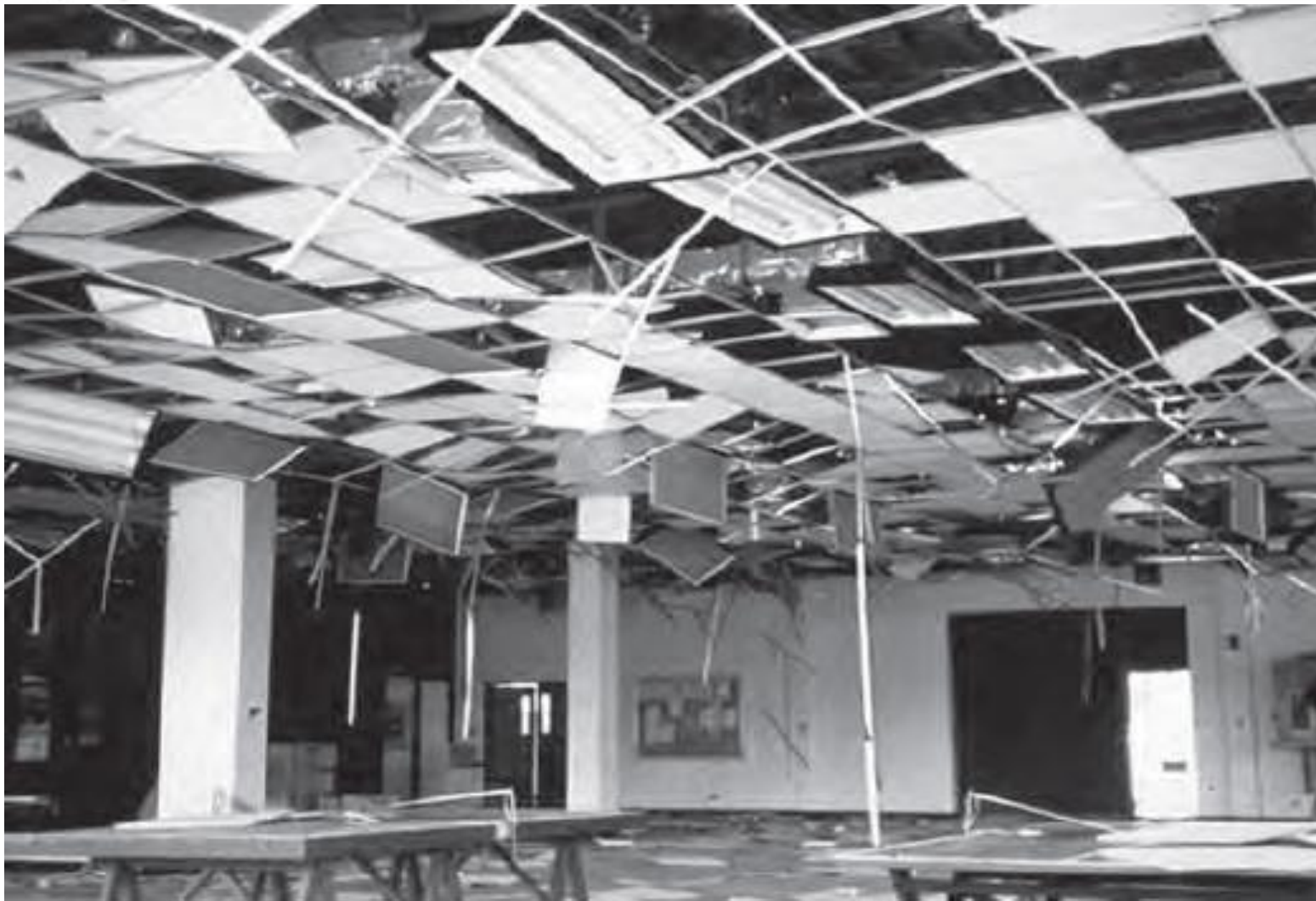
نمونه‌ای از خسارات وارد شده به سقف‌های گاذب در زلزله تایوان
